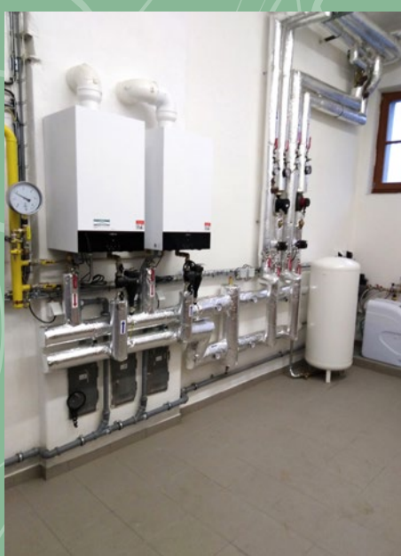
Nová kotelna v základní škole
