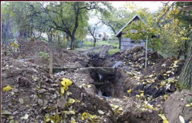
Kanalizace k družstvu.
